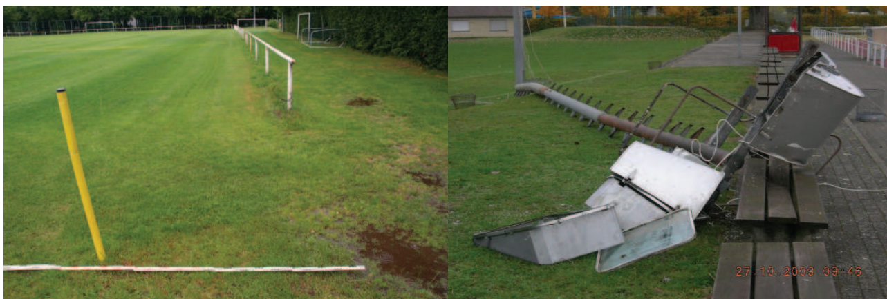
Abb. 4: links: Unzureichende Sicherheitsabstände können zu Verletzungen führen, für die unter Umständen der Betreiber verantwortlich gemacht werden kann. Rechts: Nächtlicher Mastumbruch. Schadenstelle: erster Absatz auf ca. 4 m Höhe System: Stahlmast verzinkt, abgesetzt, ca. 30 Jahre alt, Lichtpunkthöhe: 18,50 m (Foto: Roch, Lübeck).
